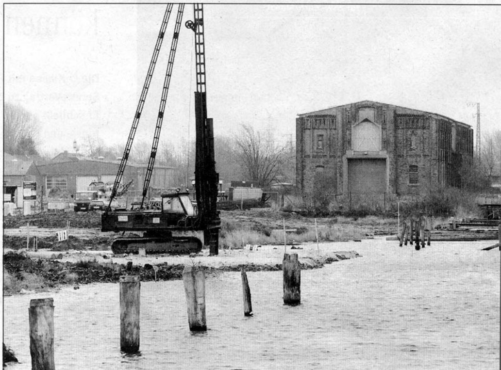
Ramme im Einsatz: Seit Anfang der Woche werden Holzpfähle am Eisenbahndock gesetzt.
